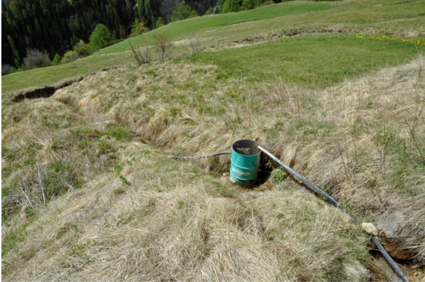
Tschlin, improvisierte Wasserfassung
